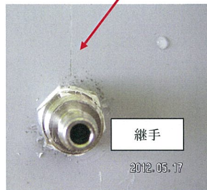
写真 2：水漏れ部拡大 亀裂
