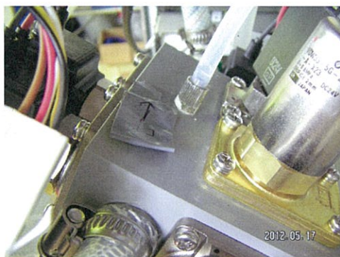
写真 1：マニホールド水漏れ部分
