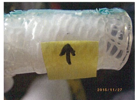
写真2：亀裂（ピンホール）部分の拡大
