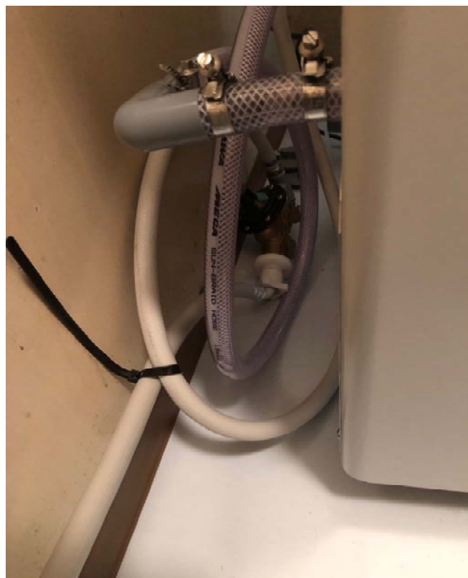
↓給水の水压が0.7MPaと高いので、給水ホースの間に減圧弁をつけている。
