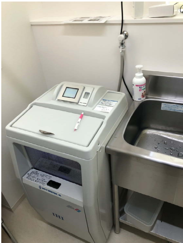
浦安内科消化器科クリニック OED設置状況 2018 2/21撮影
