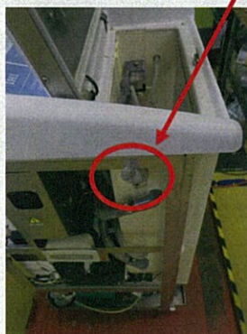
写真2：本体左側 通気配管
