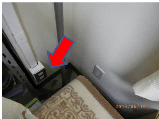
写真5:移設予定の壁コンセント ※アース付 2P壁コンセント
