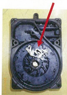
写真1：排水ポンプ内の糸くず
